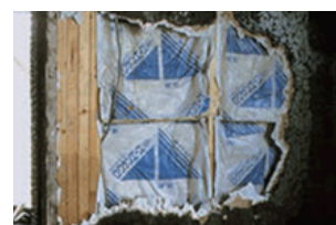
▲火災現場：石膏ボード裏側には火がまわっていません。
